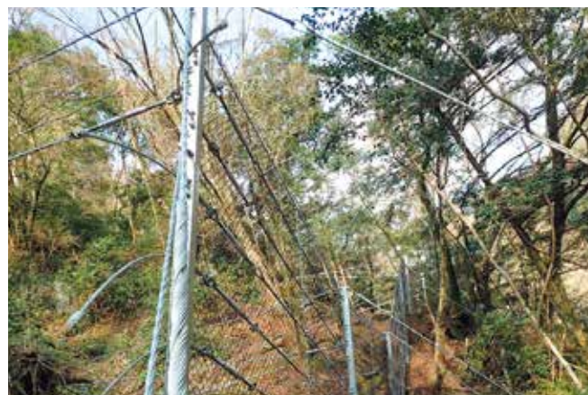
■ 自然公園内法面中腹での落石防止対策 熊本県 CFR-100 (Type-1)
