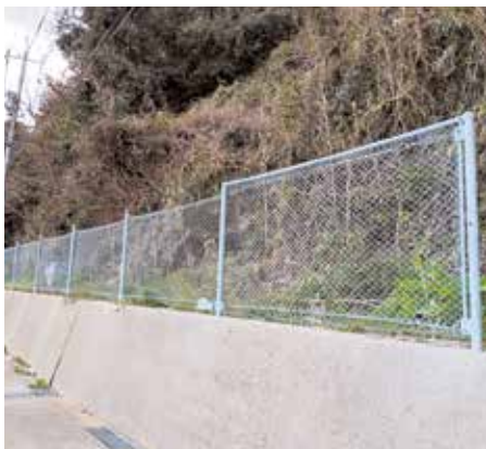
擁壁で防護柵の設置が困難な場所
