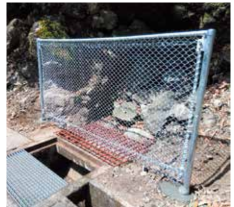
沢部の落石集中箇所に設置
